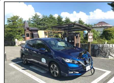
<道の駅でのEV充電器の設置>
