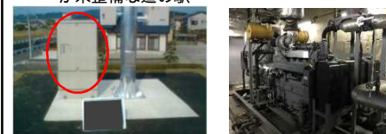
<無停電装置> <自家発電装置>
