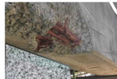
損傷状況(鉄筋露出)
