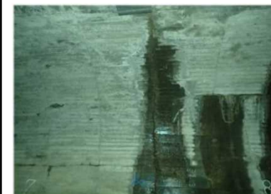
損傷状況(うき・漏水)
