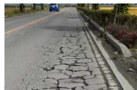
<劣化状況(地方道)>
