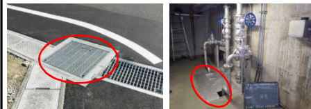
<排水施設> <排水ポンプ>
