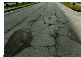
<劣化状況(国道)>
