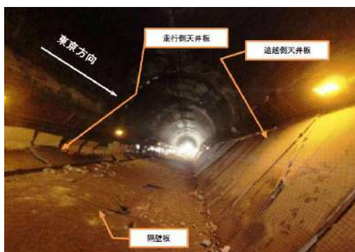
図-12 笹子トンネル天井板落下事故 12
