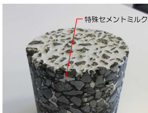
付図 1. 2. 4. 1 半たわみ性舗装のコアの事例
