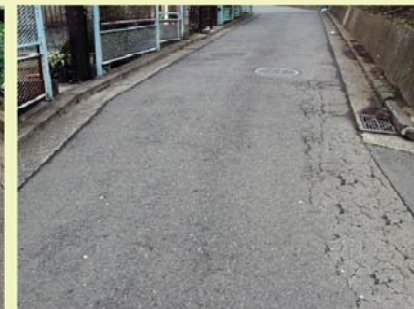
亀甲状ひび割れが路面片側に発生
