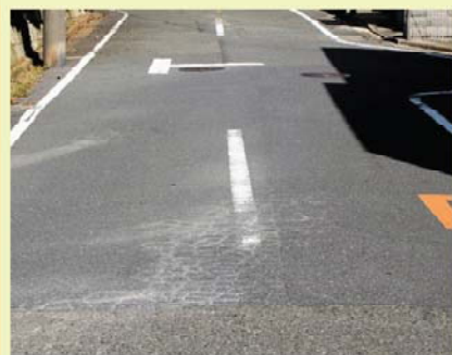
亀甲状ひび割れが局部的に発生
