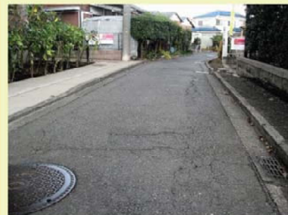
亀甲状ひび割れが路面片側に発生
