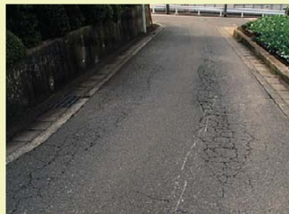
亀甲状ひび割れが車輪通過位置に発生
