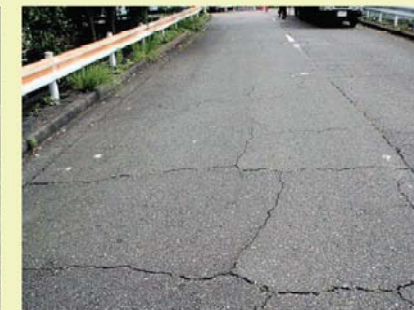
線状ひび割れが連続的に発生
