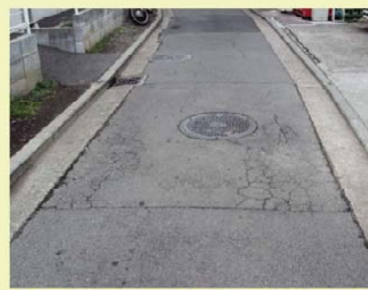
亀甲状ひび割れが占用工事の復旧箇所に発生
