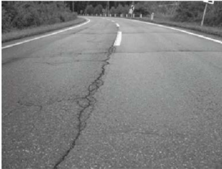
写真 3-1 凍上による車道路面のクラック
