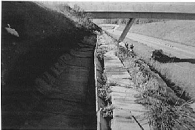
写真3-7 切土のり面小段シールコンクリートとU形排水溝の凍上被災例
