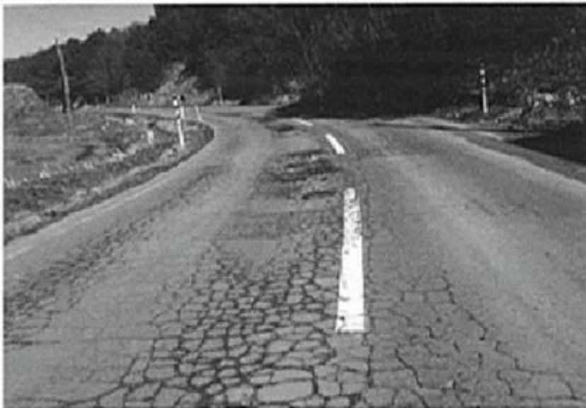
写真 3-3 融解期の支持力不足による亀甲状クラック
