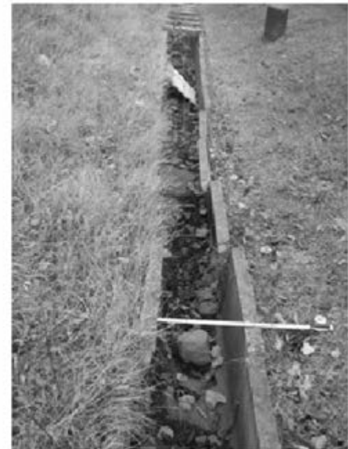
写真3-8 凍上力によるU形排水溝の被災例
