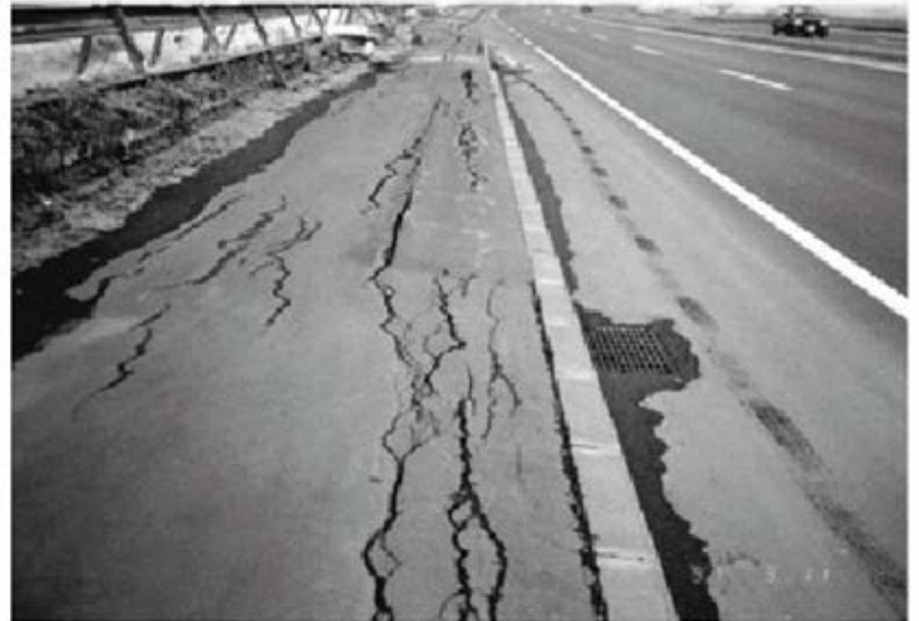
写真 3-2 凍上による歩道路面のクラック
