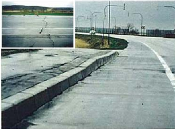
写真 3-9 ボックスカルバート上の路面の被災例
