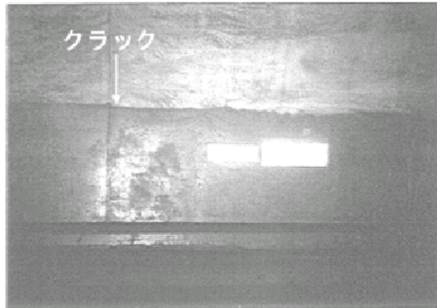
写真 3-12 トンネル覆工に発生した クラック被災例
