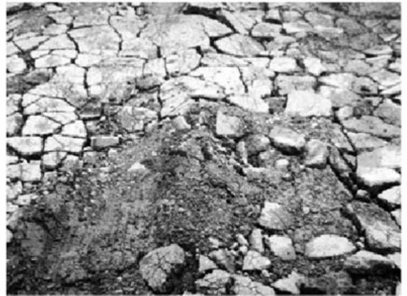
写真 3-4 融解期の支持力不足による噴泥
