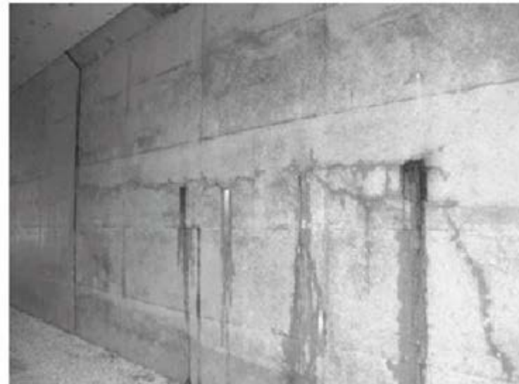
写真 3-10 ボックスカルバート側壁に発生した凍上力によるクラック
