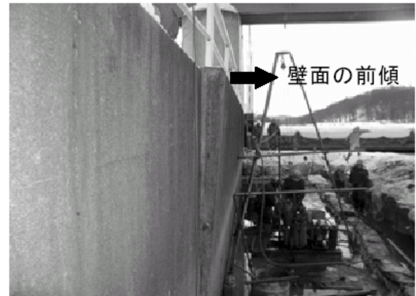
写真3-11 凍上力によるL型擁壁の被災例
