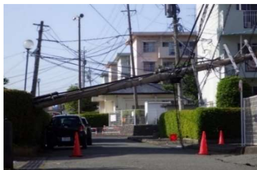
電柱倒壊例（熊本地震）
