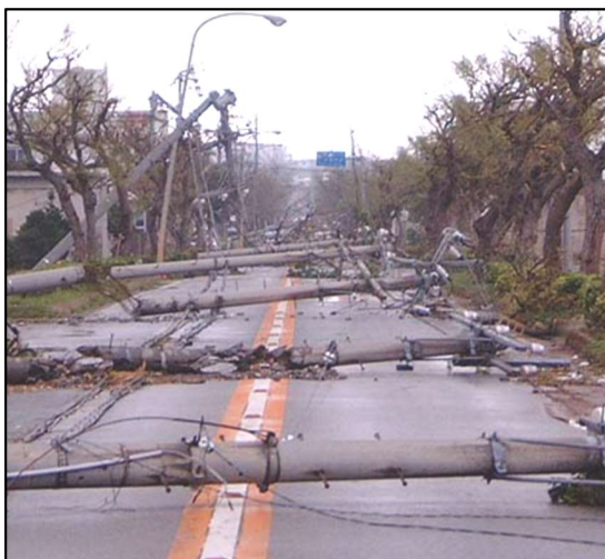
<電柱の倒壊による道路閉塞>
