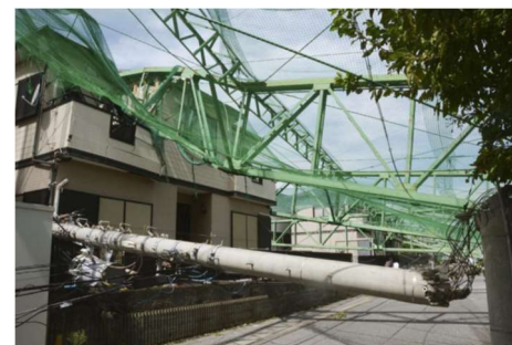
ゴルフ練習場支柱倒壊例（令和元年台風15号）
