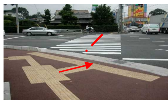
線状ブロックが横断歩道方向を示していない →横断歩道の方向と線状ブロックの方向を同一とする
