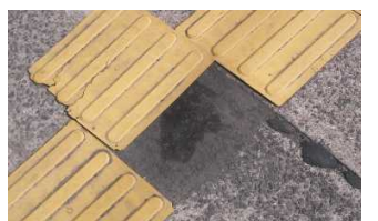
ブロックがはがれていたり、摩耗・破損したりしている →日常的に点検し、適宜改修を行う
