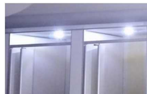
トイレの光警報装置（フラッシュライト）
