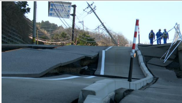
国道249号道の駅千枚田付近（輪島市）
