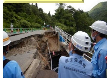
【令和4年8月の大雨】 (山形県米沢市)
