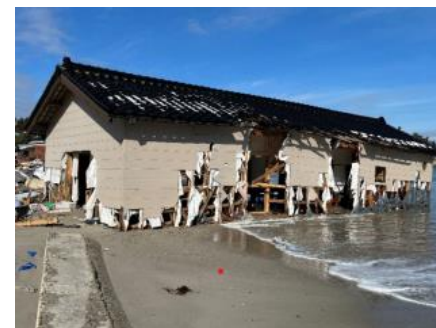
津波の引き波による住宅2階部分の流出状況（能登町）
