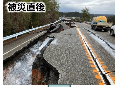
被災箇所⑤ : のと里山海道 (穴水IC~越の原IC)
