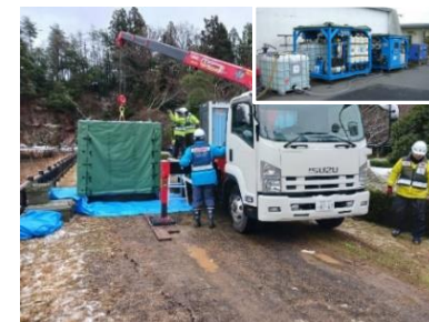
可搬式浄水装置の設置 (石川県珠洲市)
