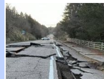
写真⑥ 国道249号 (現道活用区間) 道路崩壊 (R6.1.1撮影)
