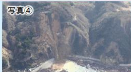
国道249号法面崩落状況
