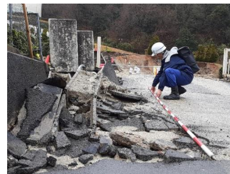
岩屋浄水場の被災（七尾市）
