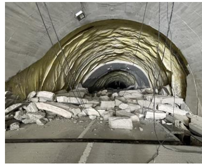
写真① 国道249号大谷トンネル崩落 (R6.1.6撮影)
