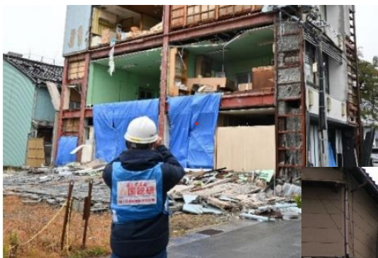
建築物の損壊状況（七尾市）
