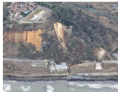
写真③ 国道249号法面崩落 (R6.1.2撮影)
