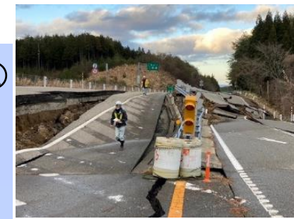
写真④ のと里山海道 (越の原IC付近) 道路崩壊 (R6.1.2撮影)
