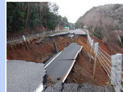
写真⑤ のと里山海道 (徳田大津IC付近) 道路崩壊 (R6.1.2撮影)
