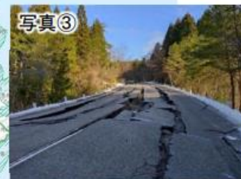
被災状況 (迂回路により普通車通行可)
