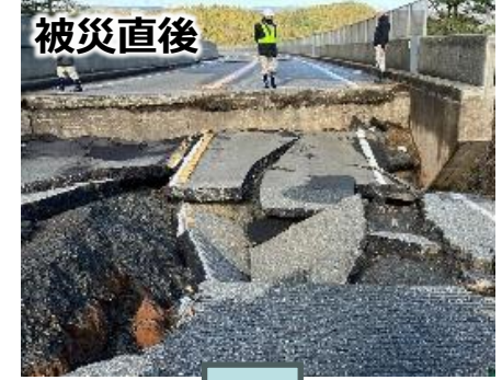
被災箇所⑥ : のと里山海道 (穴水IC~越の原IC)
