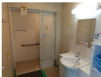
シャワー室(共用)
