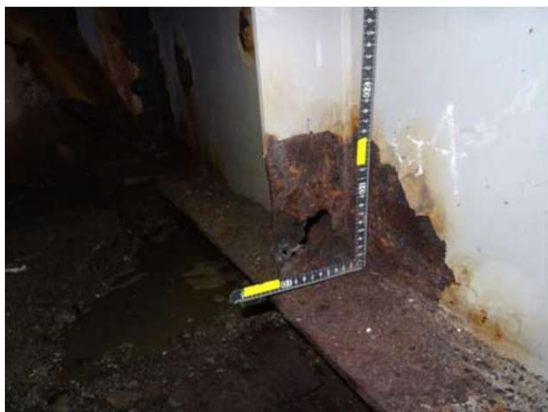
国管理 主桁腐食・欠損
