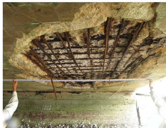
地方自治体管理 床版鉄筋露出
