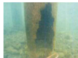
▲橋脚水中部の断面欠損
