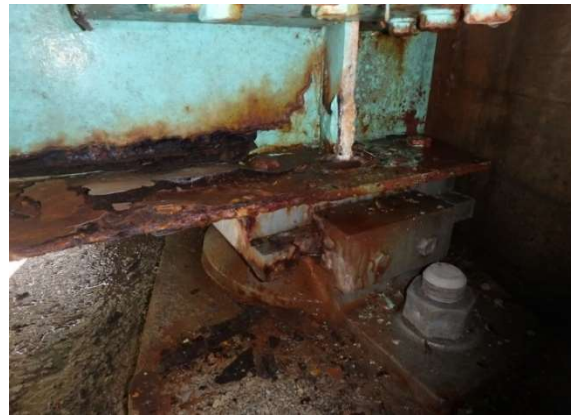
地方自治体管理 主桁腐食
