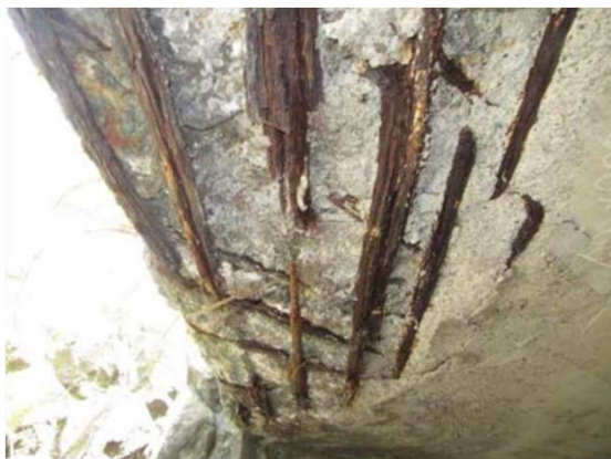
国管理 床版鉄筋露出 ※床版:橋の裏側
