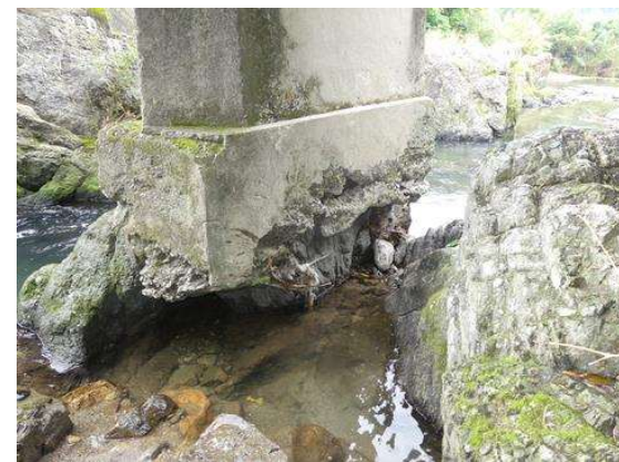
地方自治体管理 橋脚洗掘
