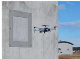
ドローンによる損傷把握
