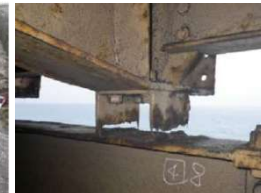
▲シールド主梁端部破断
