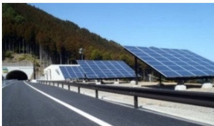
道路空間の太陽光発電設備
