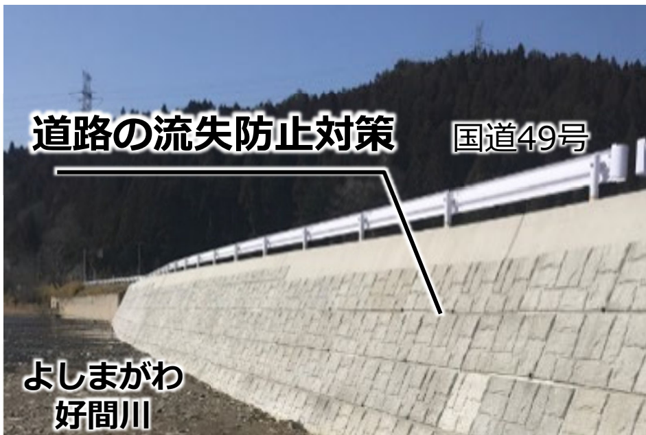
国道49号における道路流失対策 (福島県いわき市)
