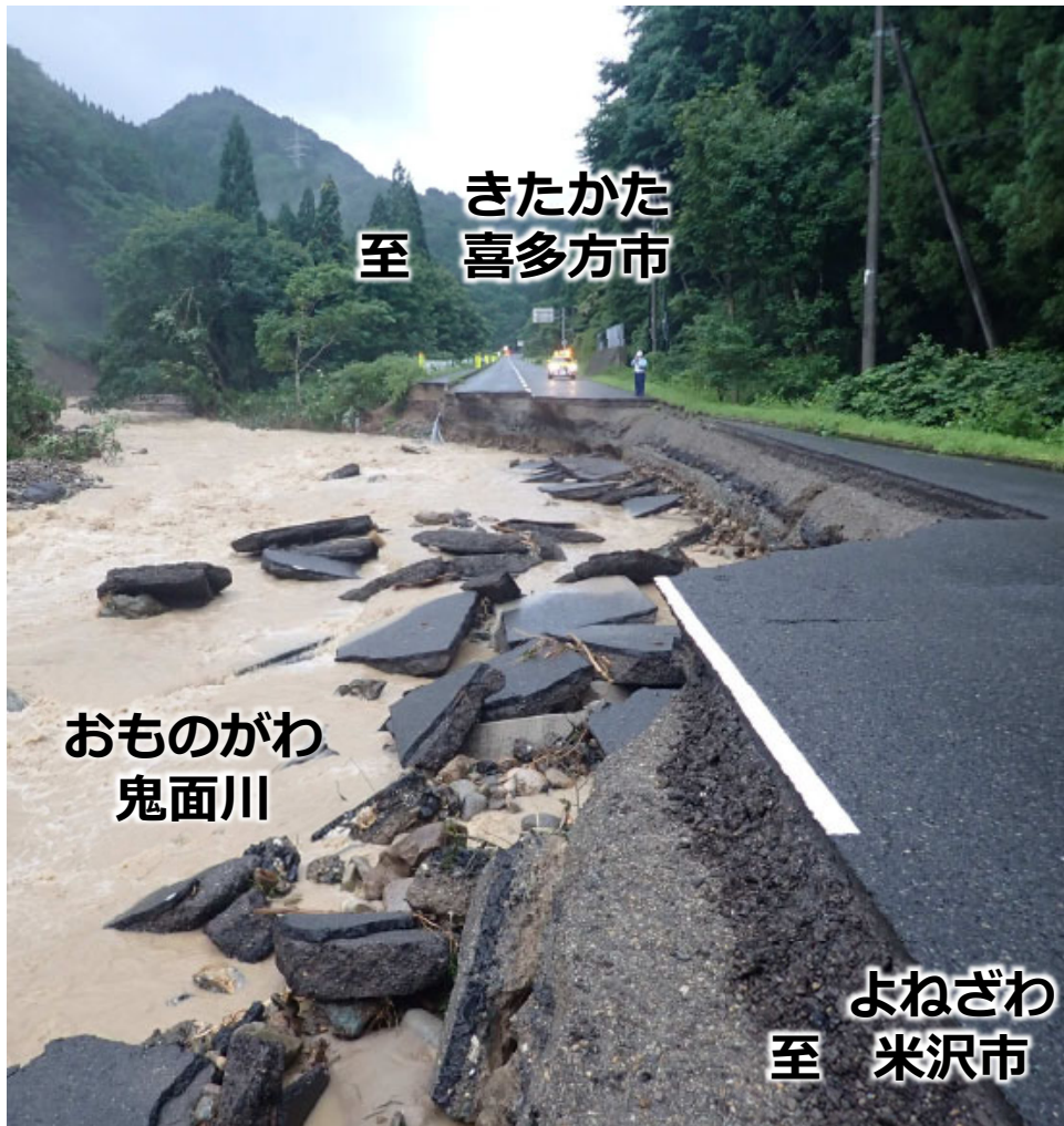
鬼面川に沿って被災した 国道121号
