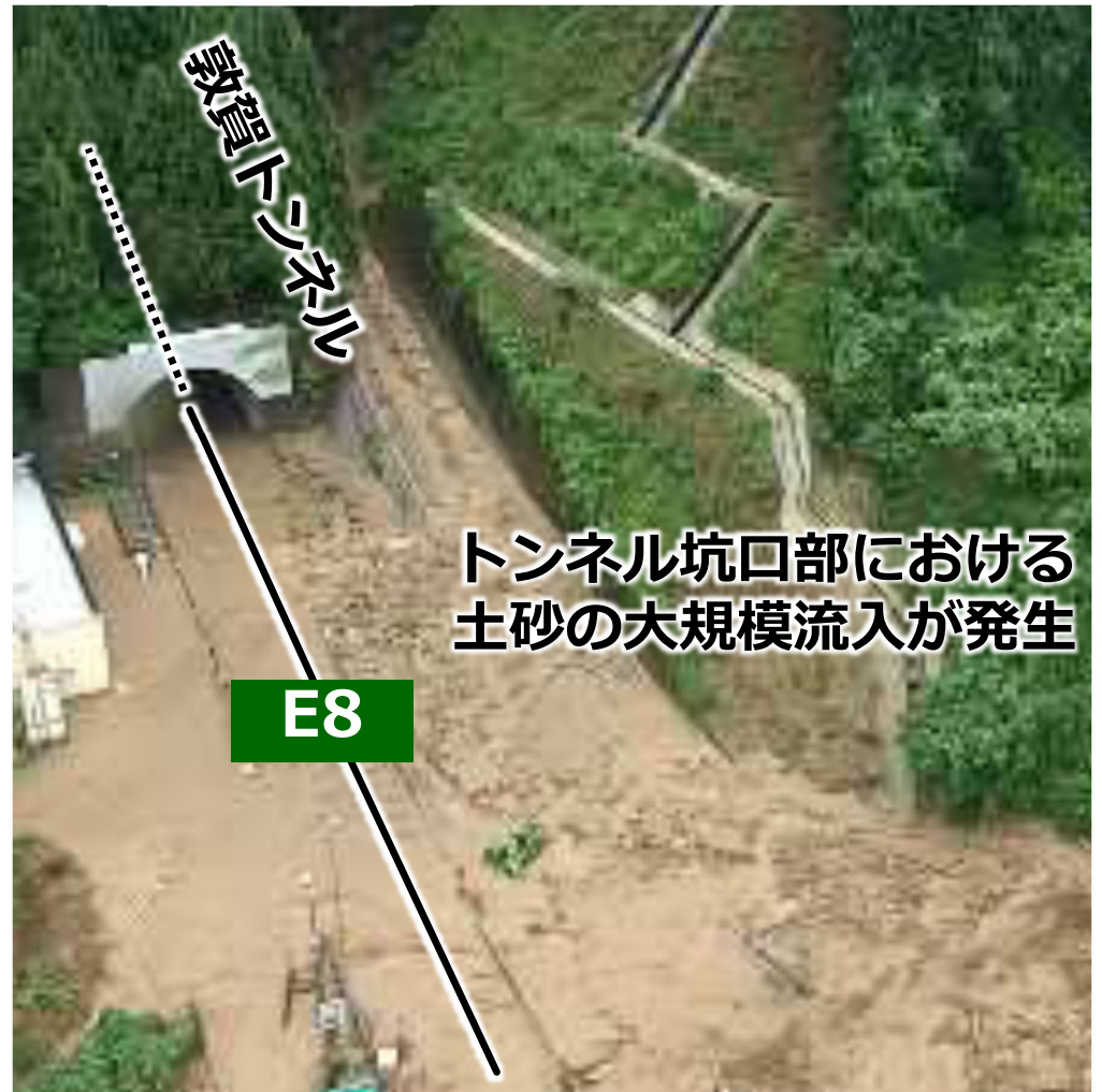
土砂の大規模流入 E8 北陸自動車道
