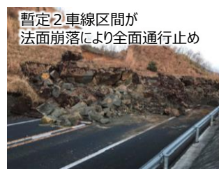
常磐自動車道の被災状況
