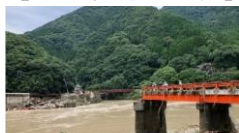
令和2年7月豪雨 熊本県道
