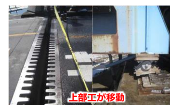
令和4年3月福島県沖地震 （伊達橋：福島県）
