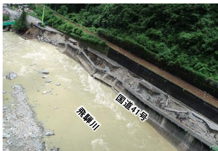
令和2年7月豪雨 国道41号
