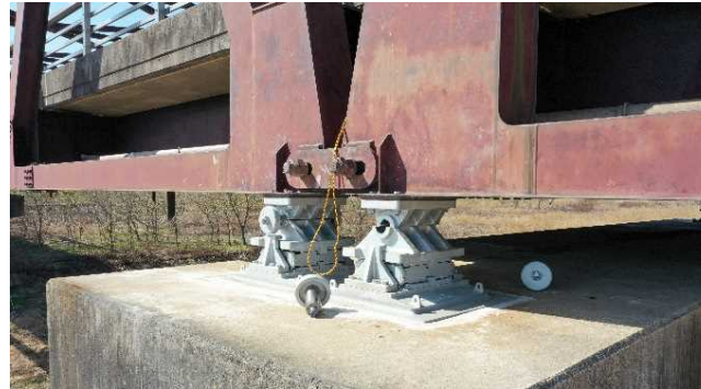
P3支承（可動）：ピンの脱落
