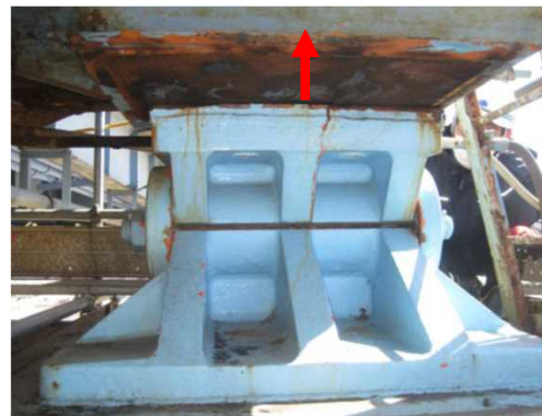
P2支承（固定）： 下弦材と上桁の間の溶接が外れ上部構造が移動
