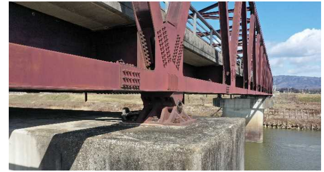
P2支承（固定）：ピンの脱落
