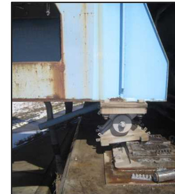
A1支承（可動）： 上部構造の移動に伴いローラーから脱落
