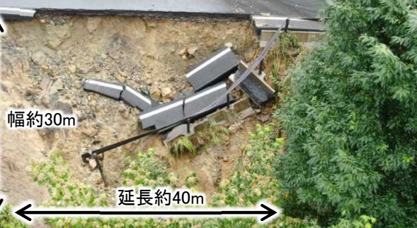
国道19号の被災状況 (8月13日 24時から通行止め)
