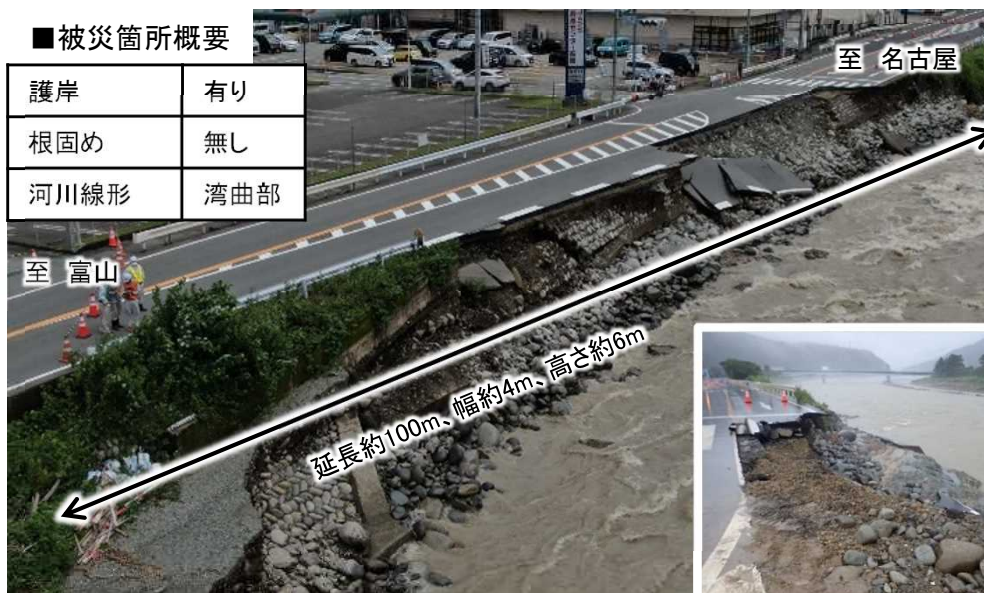
国道41号の被災状況 (8月14日 16時から通行止め)
