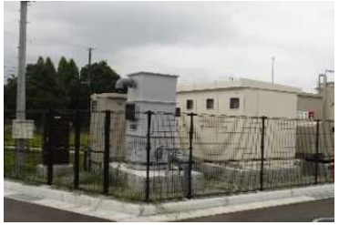
(非常用発電機)
