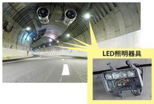
< LED道路照明灯 >
