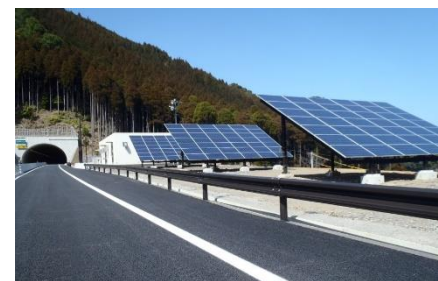
<道路における太陽光発電の活用>
