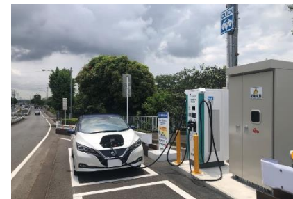
< EV充電器の公道設置（横浜市） >
