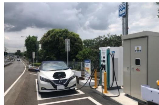
< EV充電器の公道設置(横浜市) >
