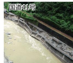
道路流失 令和2年7月豪雨 (1ヶ月半の通行止め)
