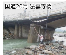
橋脚洗掘・沈下 令和元年台風19号 (1ヶ月半の通行止め)
