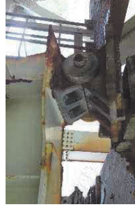
<橋梁の支承・主桁の損傷>
