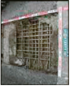
床版コンクリートの損傷状況
