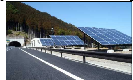
<道路における太陽光発電施設活用>
