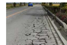
<劣化状況(地方道)>
