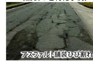
アスファルト舗装ひび割れ
