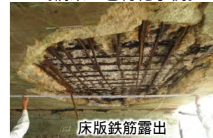
床版鉄筋露出
