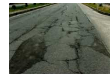
<劣化状況(国道)>
