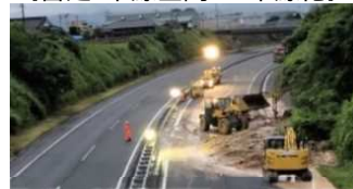
被害のない2車線を活用し、交通機能を確保
