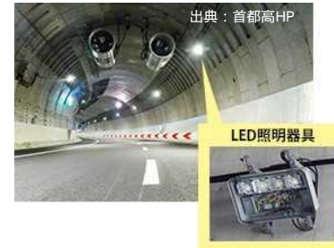
<LED道路照明灯(トンネル部)>
