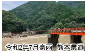
令和2年7月豪雨 熊本県道
