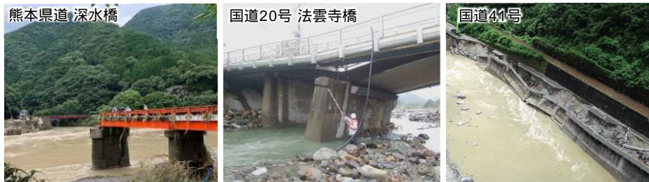
熊本県道 深水橋 橋梁流失 令和2年7月豪雨 (6ヶ月以上の通行止め) 国道20号 法雲寺橋 橋脚洗掘・沈下 令和元年台風19号 (1ヶ月半の通行止め) 国道41号 道路流失 令和2年7月豪雨 (1ヶ月半の通行止め)
