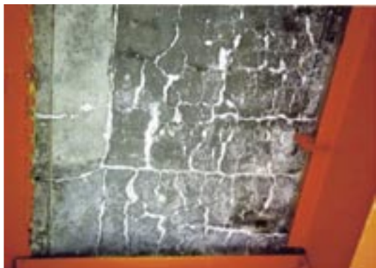
写真-11.11 床版下面のひびわれから漏水、遊離石灰を生じた例
