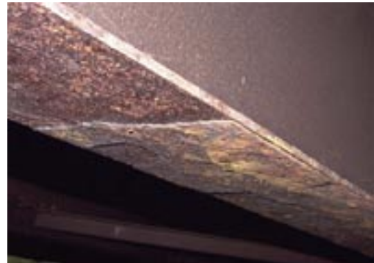
写真-1.2 耐候性鋼材に断面減少を伴う異常な錆が発生した例
