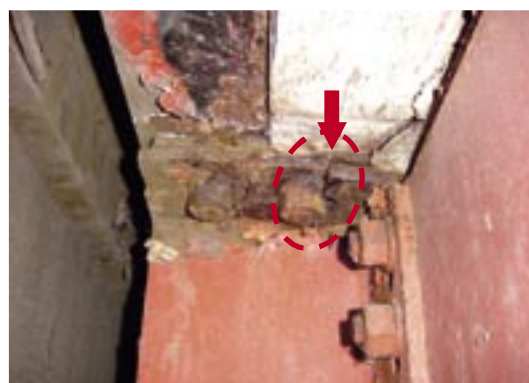
写真-2.7 亀裂が生じた例
