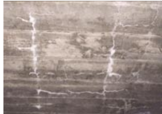
写真-11.10 床版下面のひびわれから遊離石灰を生じた例
