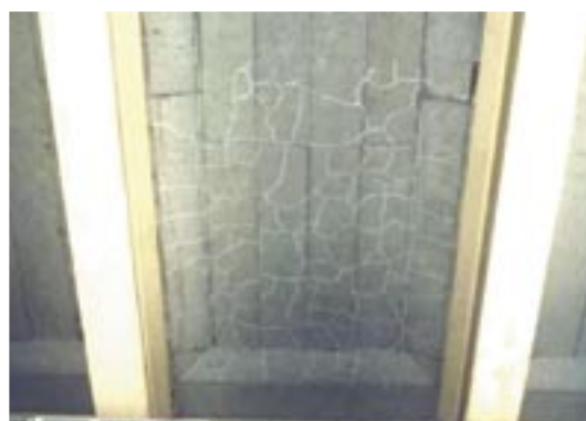
写真-11.6 床版下面に格子状のひびわれを生じた例 (注:ひびわれはチョークでマーキングしてある)
