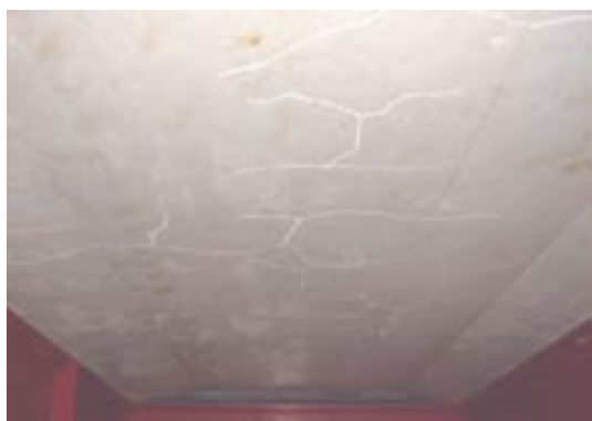
写真-11.3 床版下面に二方向のひびわれを生じた例 (注:ひびわれはチョークでマーキングしてある)
