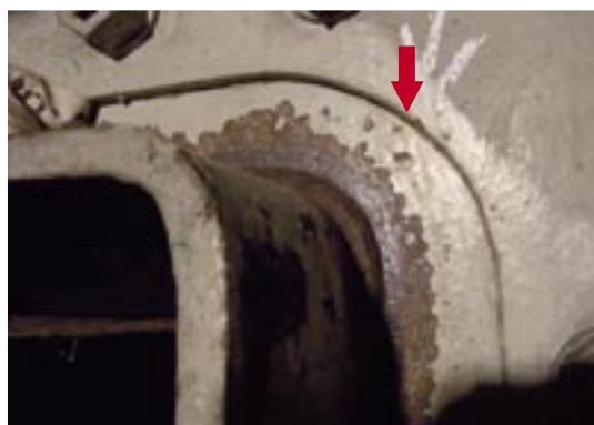
写真-2.1 桁端切欠きR部に生じた例
