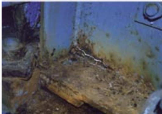
写真-1.11 腐食と同時に亀裂を生じた例 (注: 亀裂をチョークでマーキングしている)
