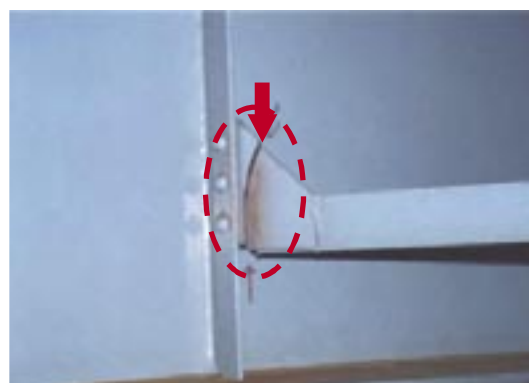
写真-2.9 亀裂の進展により破断が生じた例
