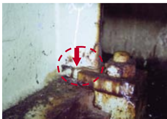
写真-2.6 亀裂が生じた例
