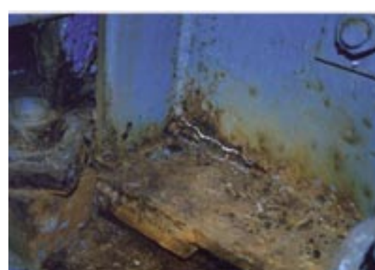
写真-2.5 錆と同時に亀裂が生じた例 (注：亀裂をチョークでマークしている)
