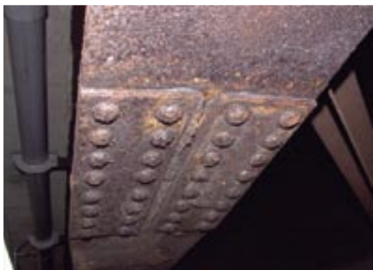
写真-1.7 耐候性鋼材の錆の状態が一樣でなく、断面欠損を伴う例
