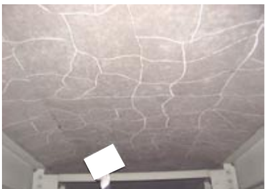
写真-11.5 床版下面に格子状のひびわれを生じた例 (注:ひびわれはチョークでマーキングしてある)
