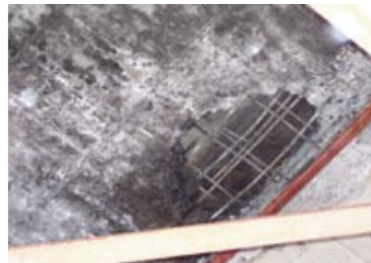
写真-11.12 コンクリート塊が抜け落ちた例
