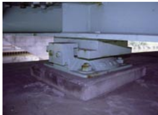
写真-1.6 断面欠損を伴わないと見なせる程度の軽微な錆が発生した例
