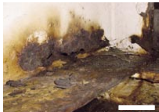
写真-1.15 腐食と同時に亀裂(断面欠損)を生じた例
