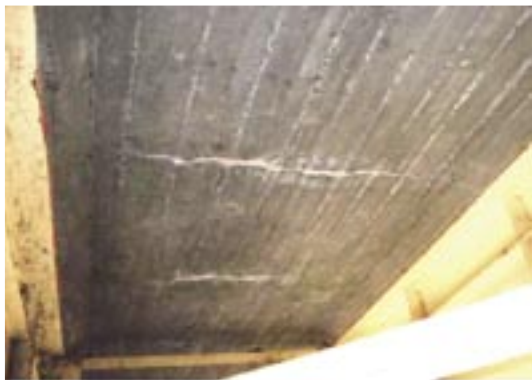
写真-11.9 床版下面のひびわれから遊離石灰を生じた例
