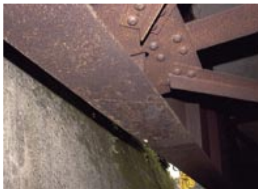
写真-1.8 耐候性鋼材の錆の状態が一樣でなく、断面欠損を伴わない例
