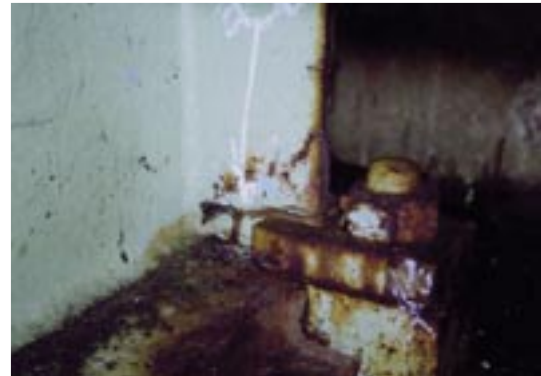
写真-1.12 腐食と同時に亀裂を生じた例
