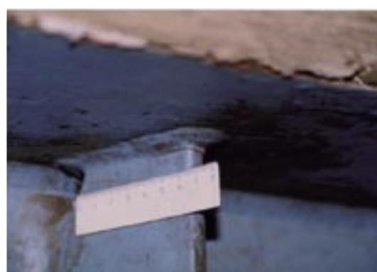
写真-2.2 垂直補剛材の溶接部に生じた例
