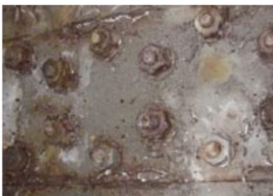
写真-1.9 ボルトに断面欠損を伴う錆が発生した例
