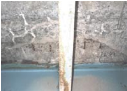
写真-11.7 床版下面のひびわれとコンクリートの剥離、鉄筋露出が生じた例
