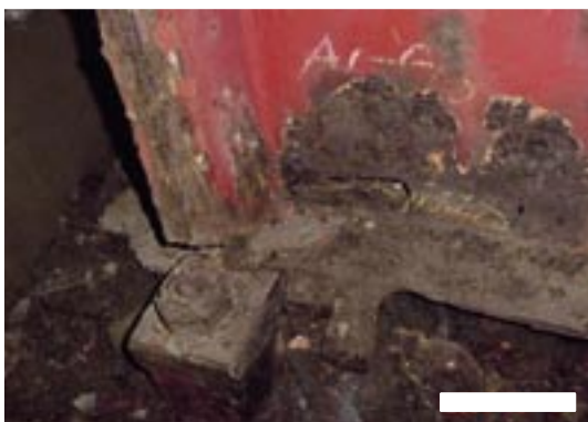
写真-1.14 腐食と同時に亀裂(断面欠損)を生じた例
