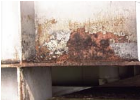
写真-1.1 集中的に錆が発生した例
