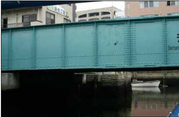
位置: 塗装剥離 撮影日:
