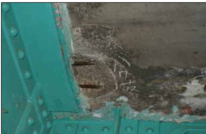
位置: 床版部鉄筋露出 撮影日:
