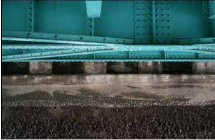
位置: 伸縮部より漏水 撮影日:
