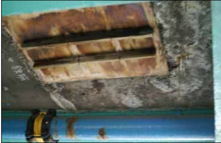
位置: 点検孔漏水、遊離石灰 撮影日:
