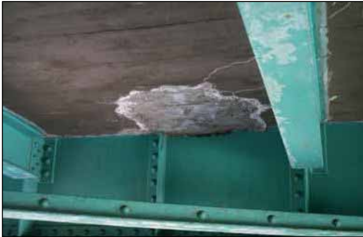
位置: 床版クラック、遊離石灰 撮影日:
