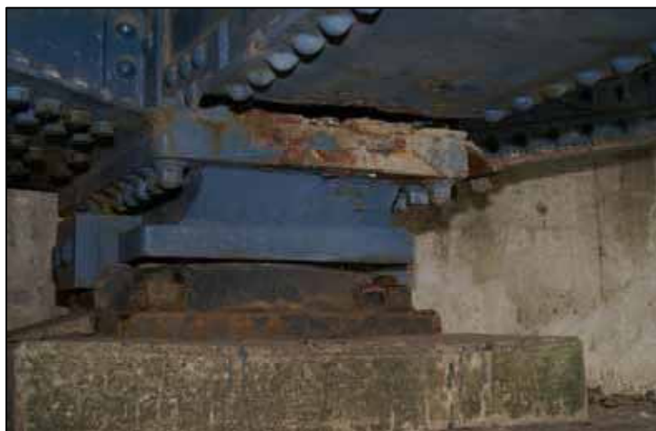
位置： 支承錆、劣化 撮影日：
