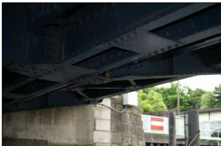
位置： 鋼材変形 撮影日：
