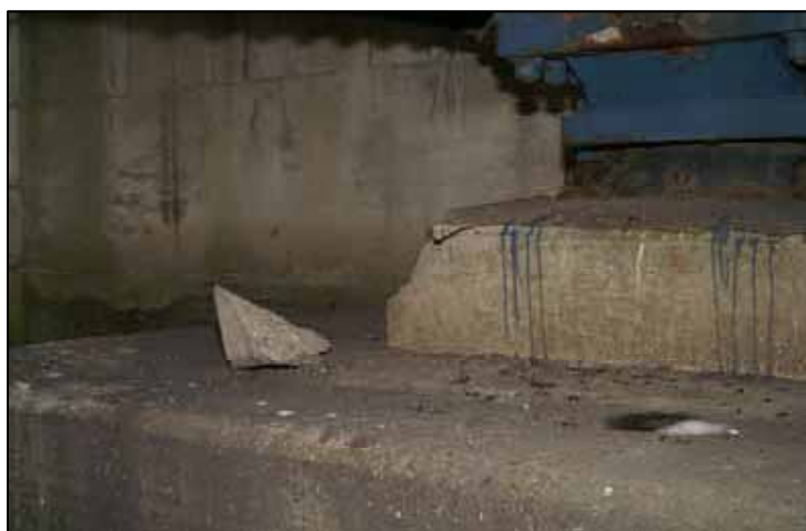
位置： 支承台座橋破損 撮影日：
